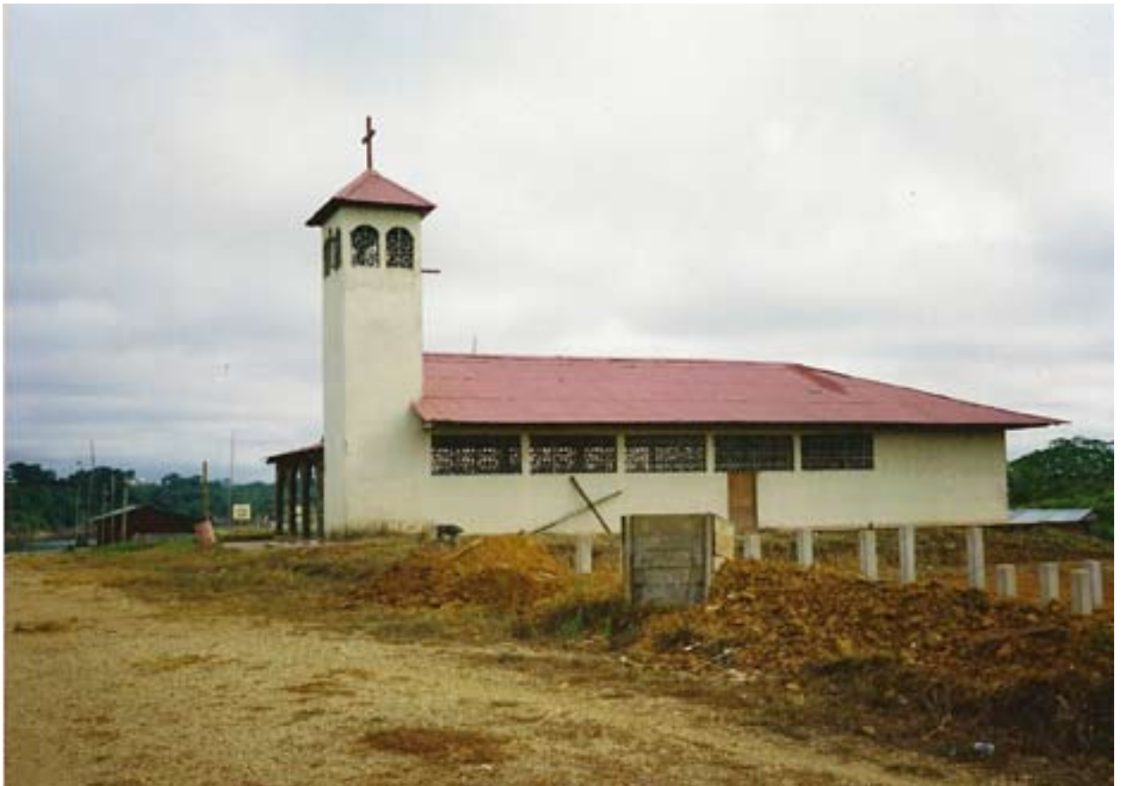
Iglesia de La Pedrera en construcción en los noventa. Foto Carlos Rodríguez
